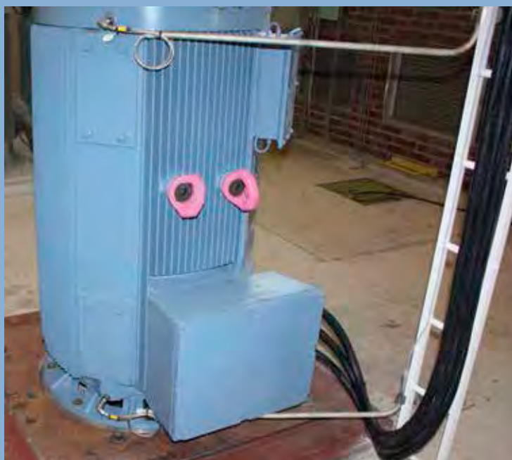
Bilden visar en ny, varvtalsreglerad motor på 400 kW monterad på undergjutning med vibrationsdämpande epoxi samt planbearbetad monteringsplåt. Motorn har utrustats med givare för kontinuerlig vibrationsövervakning. Denna motor ersätter tidigare motor med effekt 500kW.
