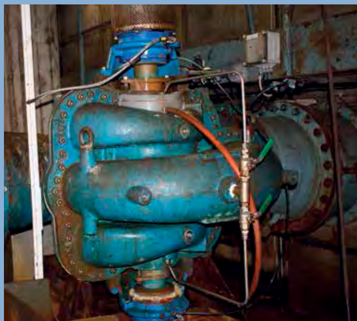
Bilden visar den pump som är ansluten via kardanaxel till motorn på bilden intill. Givare är anslutna för kontinuerlig vibrationsövervakning. Även pump-hjulsdiametern har optimerats för maximal energianvändning samt lägsta möjliga vibrationsnivå.
